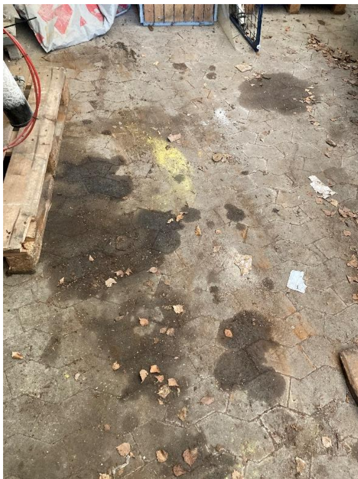
Foto 5 Belægning med spor fra oliespild fra gaffeltrucken
