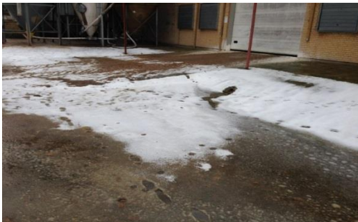
Forplads hus 2. Foran nærmeste røde stolpe ses et rørdøb. Røret går til arealet mellem hus 1 og hus 2 og benyttes til bortledning af overfladevand herfra.
