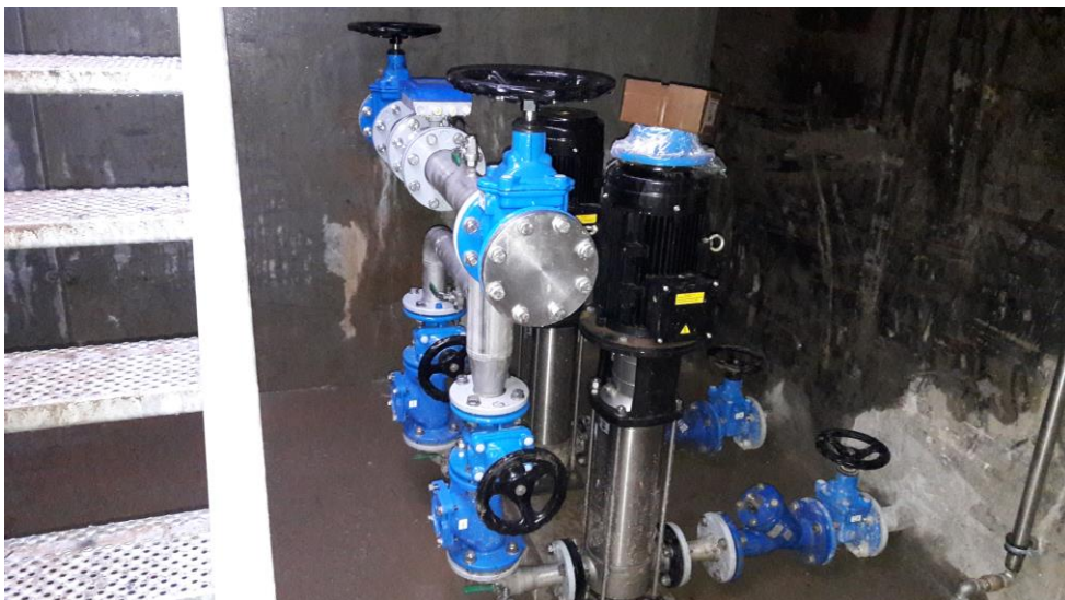
Fig. 12. Bobøl Deponi. Ny underjordisk perkolatpumpe til trykledning.
