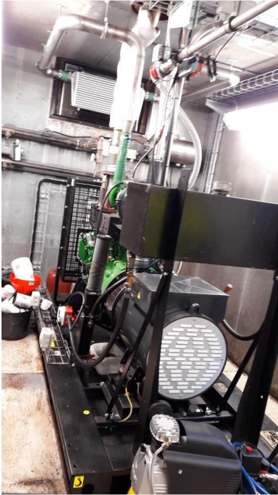
Fig. 6. Bobøl Deponi. Gasmotoren er en ny kombineret gas- og diesel motor, som er installeret i juni 2017.
