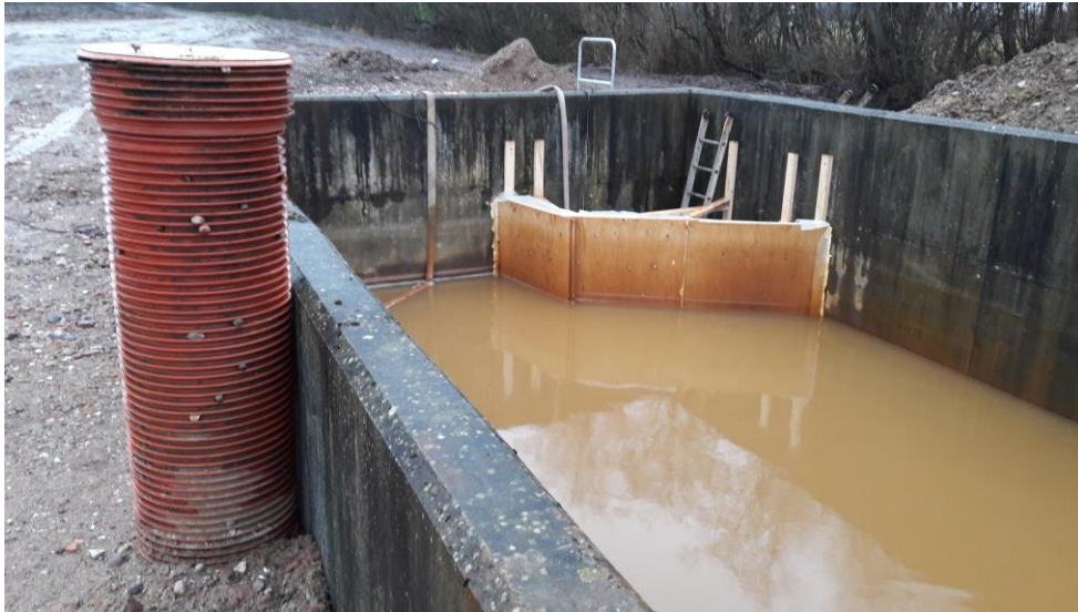
Fig. 10. Bobøl Deponi. Pumpetank ved med trykledning til offentligt renselæg.
