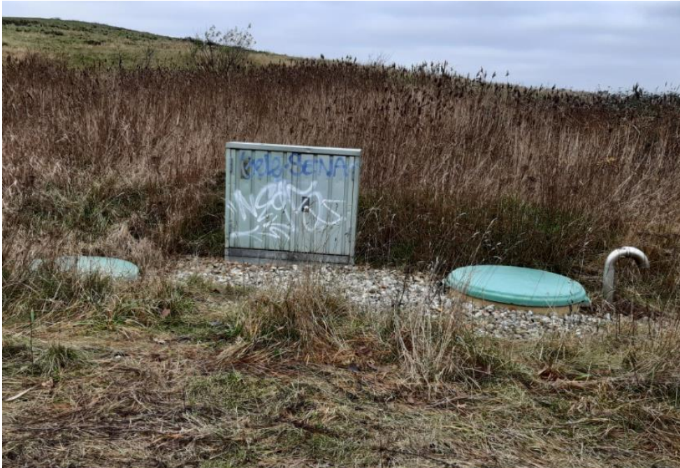
Den sydlige pumpestation
