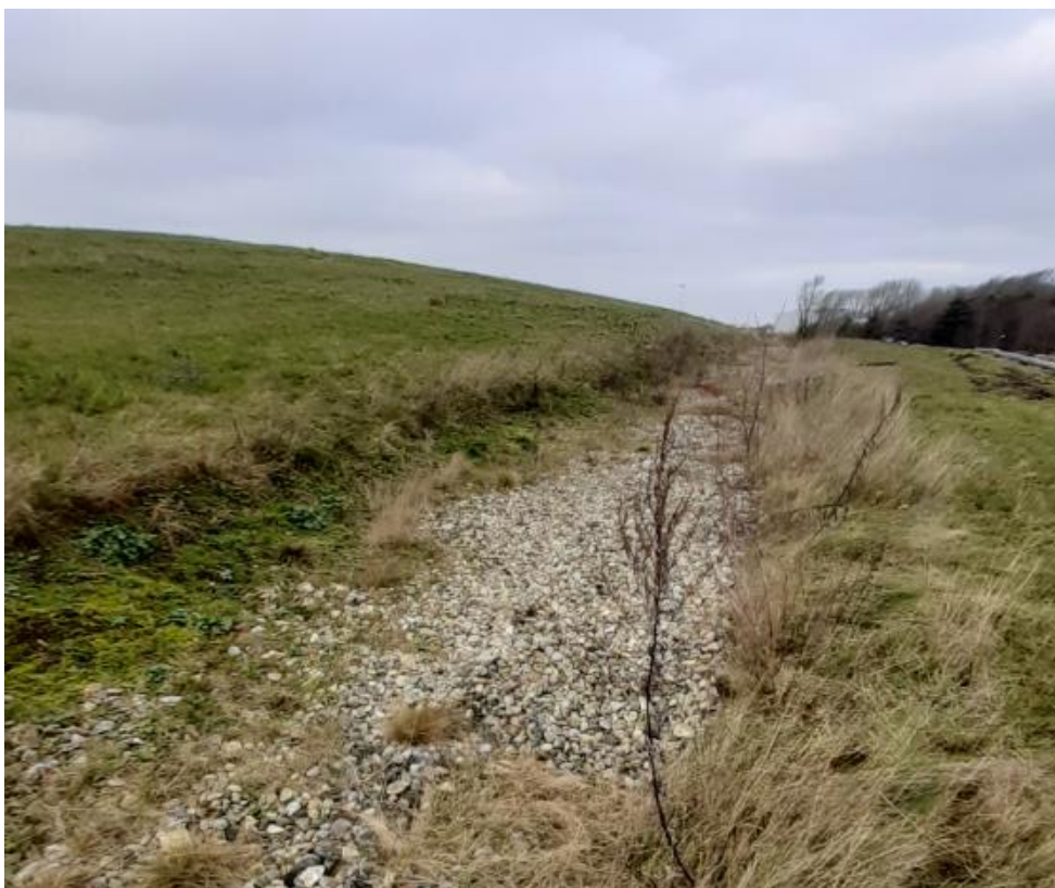
Drænsystem/faskine til afledning af overfladevand
