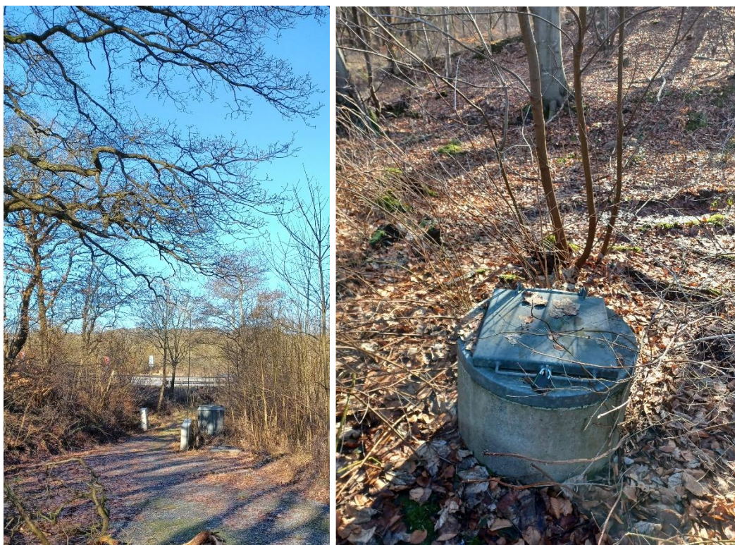
Figur 2. Perkolatpumpestation (venstre) og perkolatbrønd 2 (højre).
