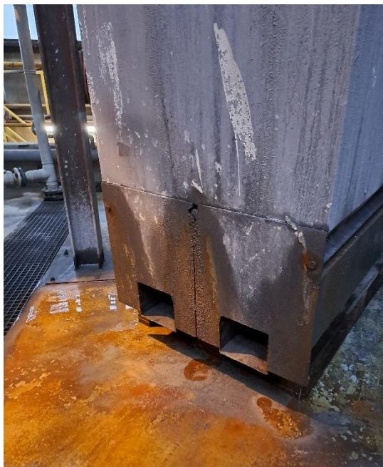
Foto 20 Vand til afløb fra container til OS
