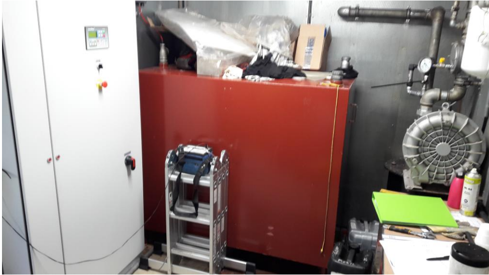
Billede 4 1200 liters tank placeret i containeren med gasmotoren.
