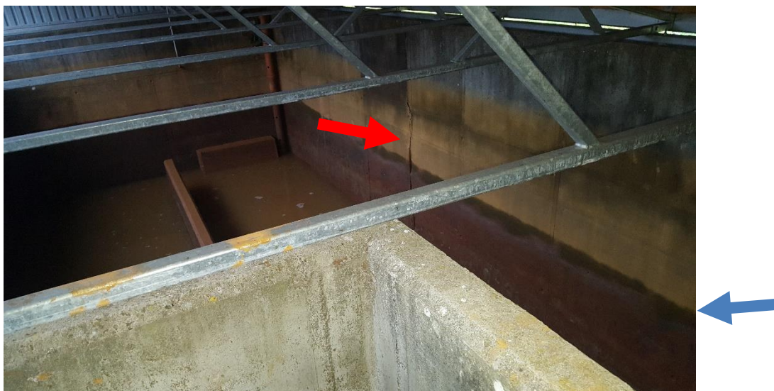
Billede 3 overdækket perkolattank. Stregen på væggen (Blå pil) viser normal vandstand. Overfladiske revne (rød pil) leder til at Miljøstyrelsen ønsker tanken efterset.
