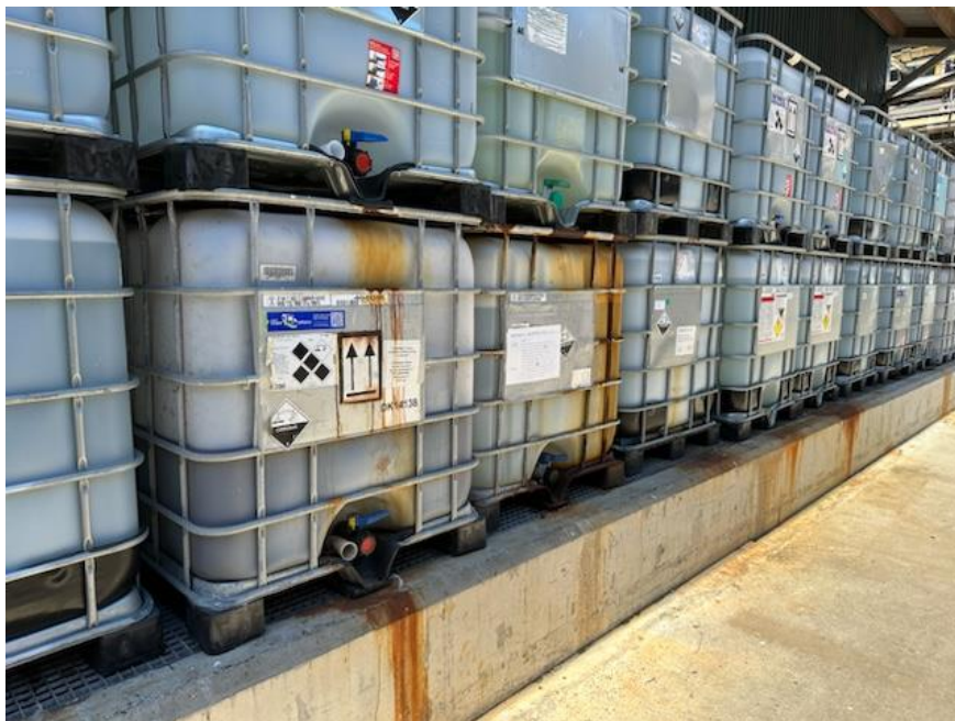
Figur 1 Pallettanke placeret over spildbakker.
