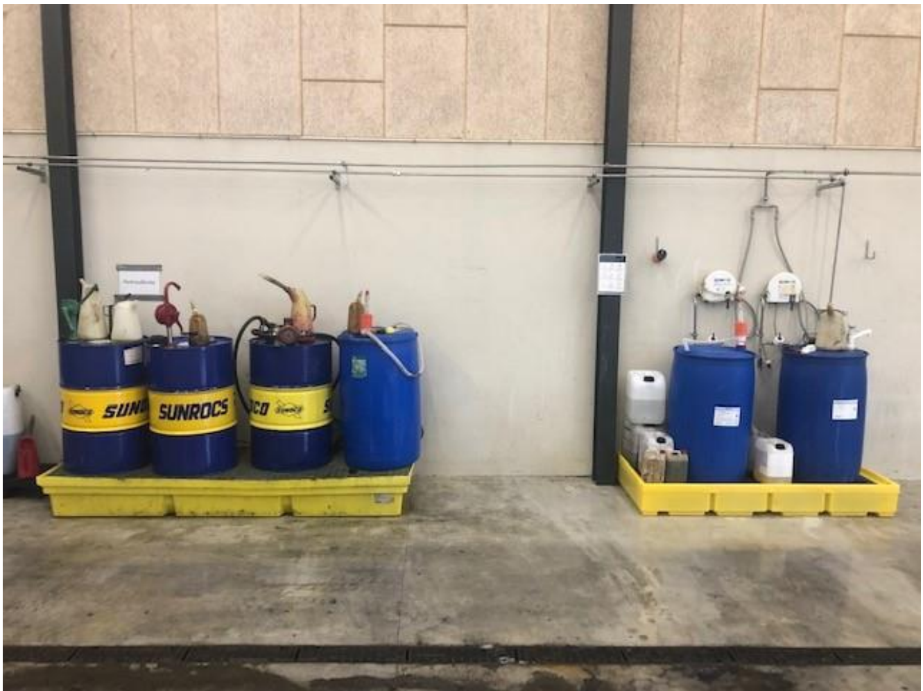
Den nye spildbakke ses til højre.
