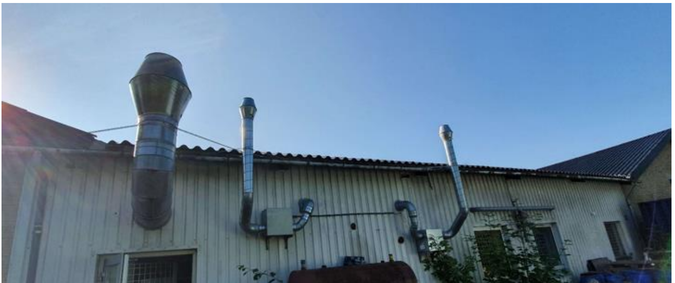
Udsugningsafkast er alle ført op til 1 meter over tag.
