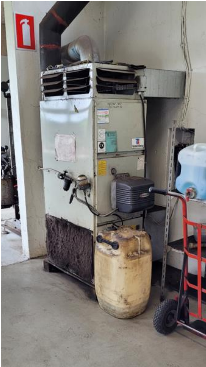
Oliefyret kalorifere på autoværkstedet. Der benyttes en plastdunk til fyringsolie.
