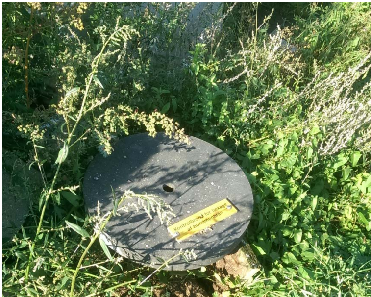
Foto 5. Kontrolbrønd ved lagune til tjek af lækage af bundmembran
