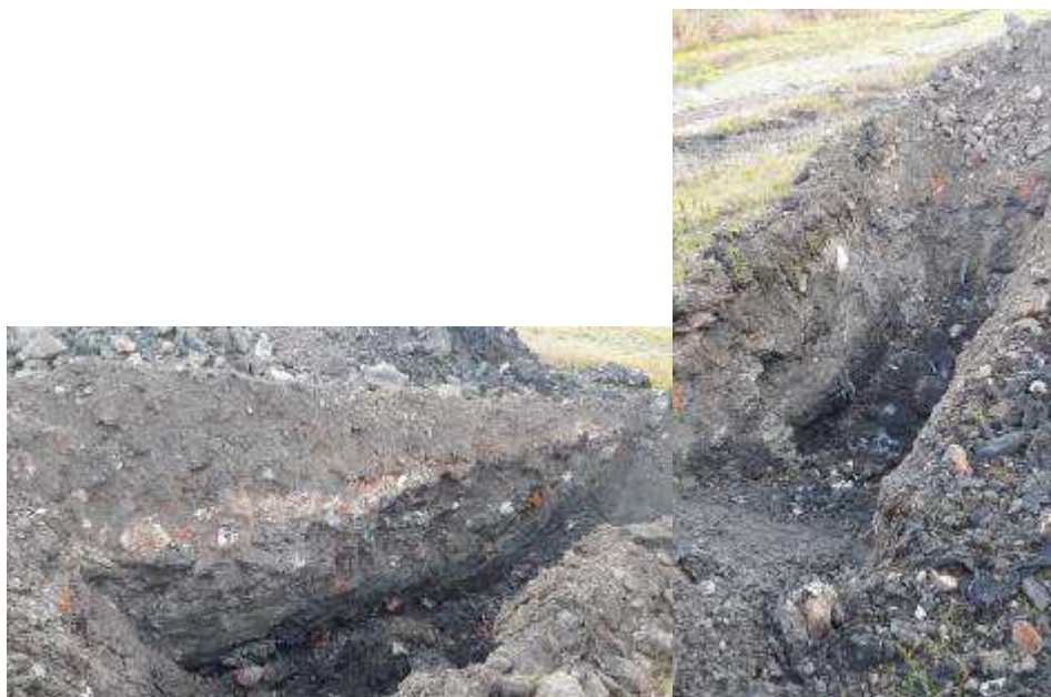
Figur 3: Prøvegravning i mellemafdækning på etape 2, hvor der hidtil har været kompostering af have- og parkaffald.
