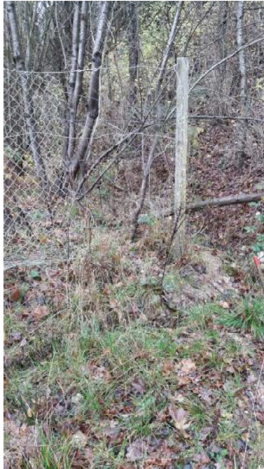
Figur 1: Hul i hegnet i det nordøstlige hjørne ved etape 2 og 8
