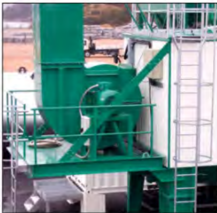
Ventilator på repos.
