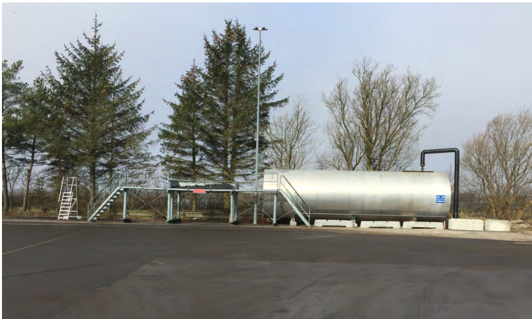
Ny 40 m 3 bitumentank placeret langs Håndværkervej
