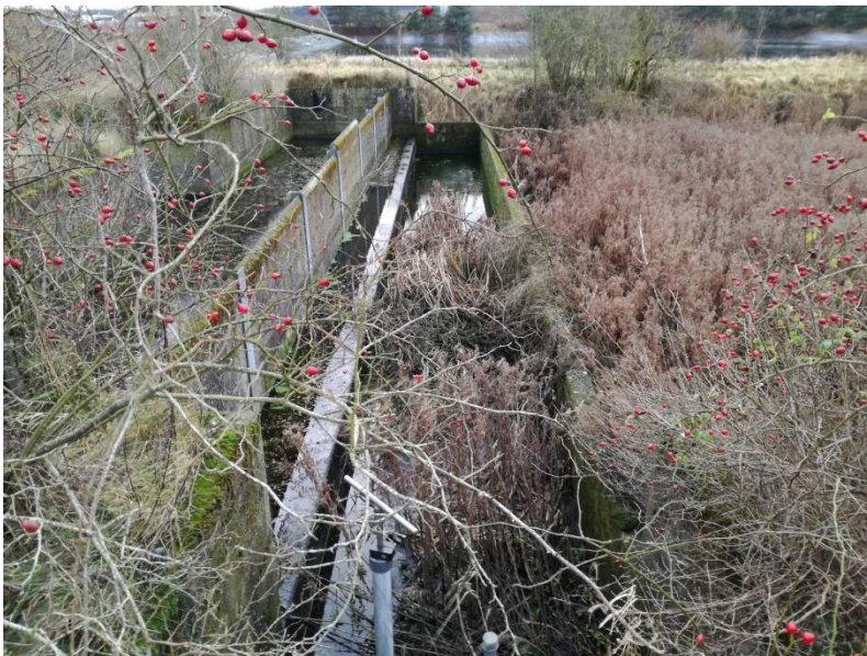
Billede af primærbassinet, olieudskiller og sandfang.
