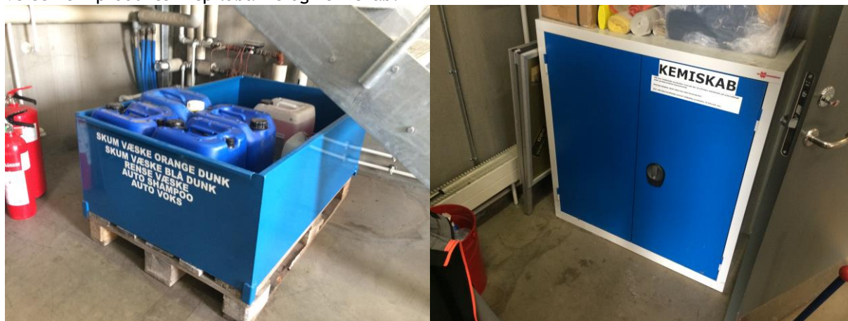
Væsker i spildbakke og kemiskab på tæt beton i garage.
