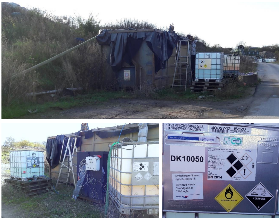
Figur 4. Perkolatbehandlingsanlæg. 1) Anlægget set fra nordøst. 2) Hydrogenperoxidbeholdere samt doseringsskab. 3) Faremærkning af hydrogenperoxid (brintoverilte).
