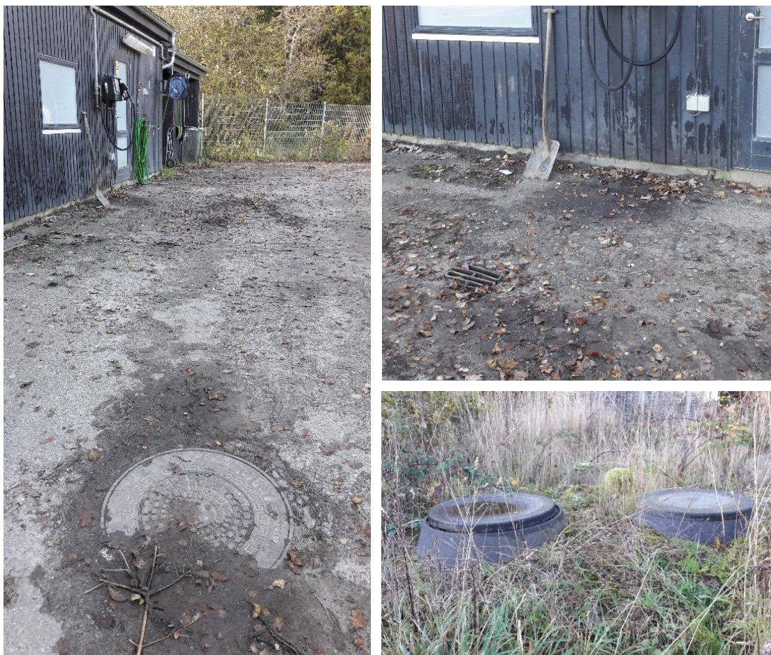
Figur 6. Olieudskillere. 1) Vaskeplads med dæksel til olieudskiller forrest. 2) Aftapningshane med sandfang forrest. 3) Olieudskiller og sandfang ved garage.
