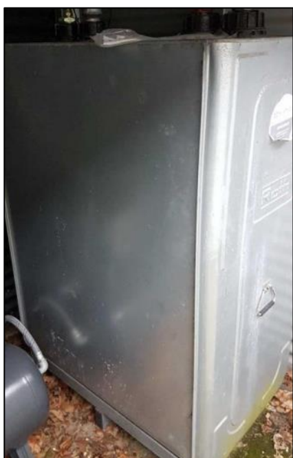
Tank til spildolie, 2018
