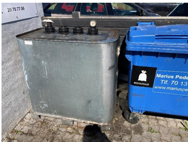
Foto 1: Udendørs 1000L spildolietank samt 660L container til restaffald
