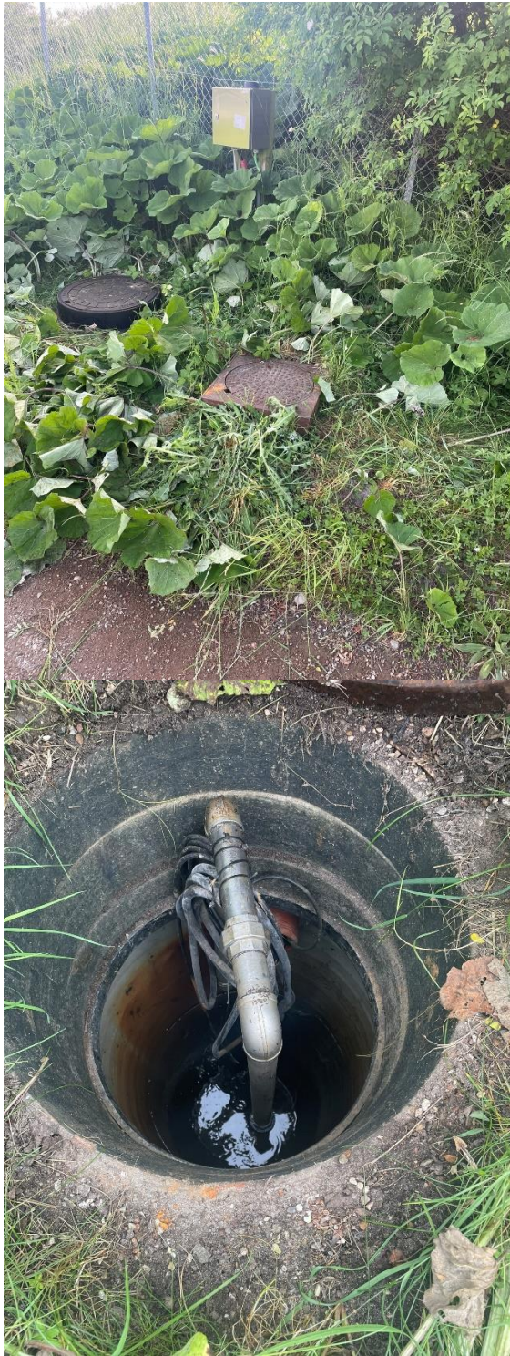
Synligt ny-tilset drænpumpebrønd, i drift uden opstuvning.
