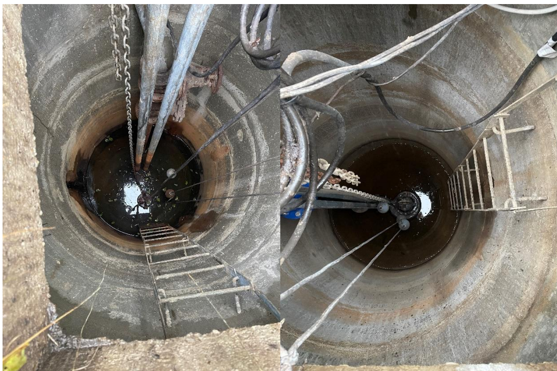
Figur 4: Den hhv. vestlige og østlige perkolatbrønd
