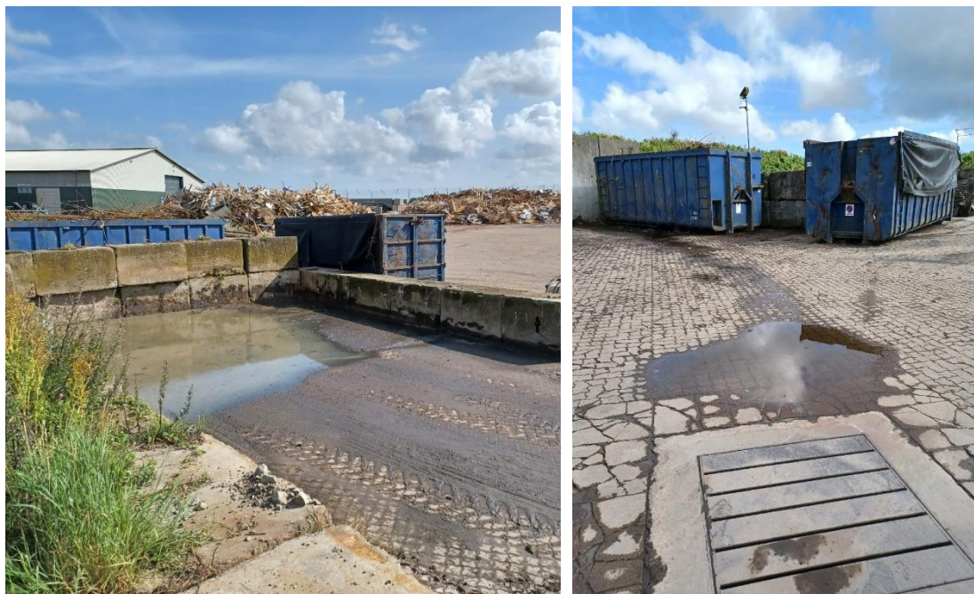
Figur 6. Bås til slamafvanding. Tv: Regnvand i båsen til slamafvanding. Th: Vandets vej fra båsen, under betonblokke og videre til afløb.
