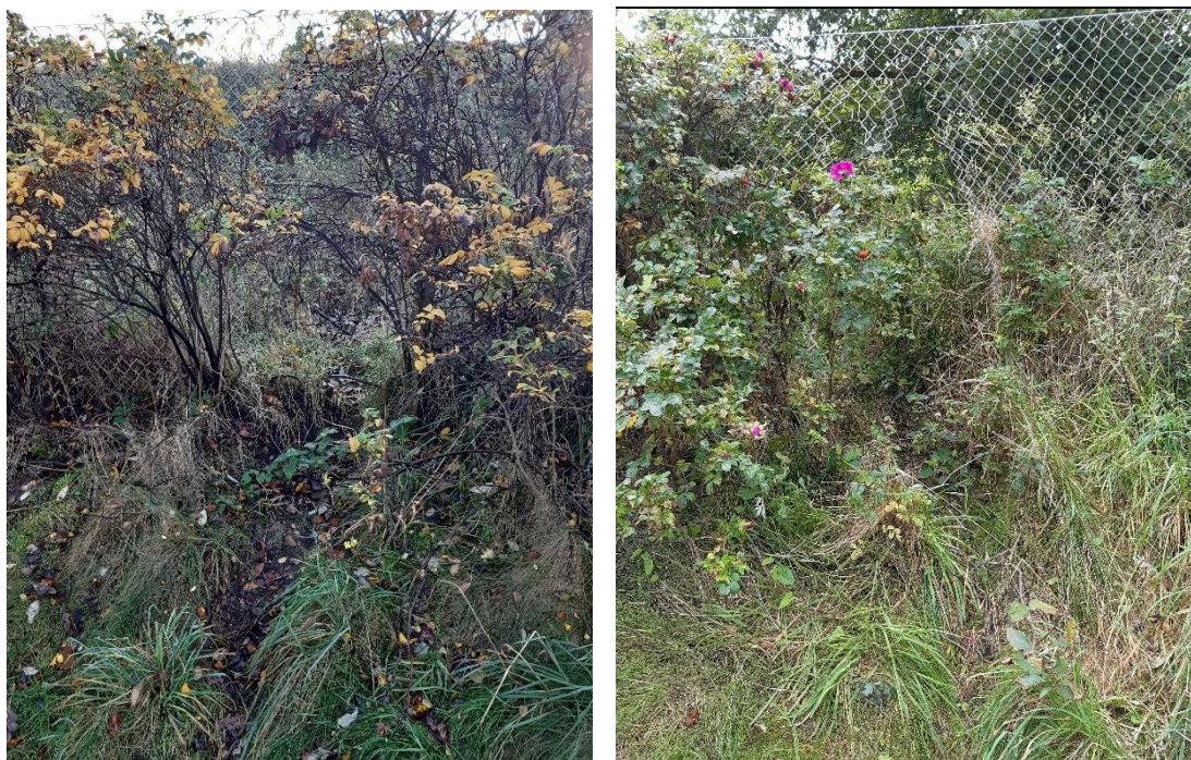
Figur 5. Huller i hegn. Til venstre: Foto fra tilsynet i 2021. Til højre: Foto fra nærværende tilsyn.
