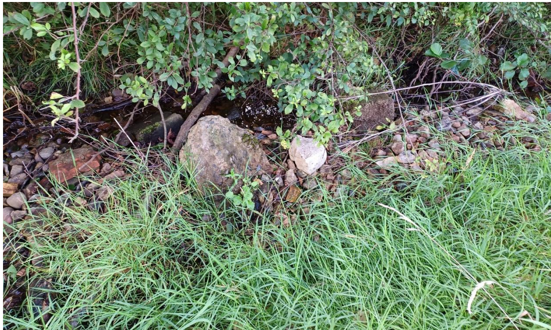
Figur 8. Brokker i faskine syd for etape 2.
