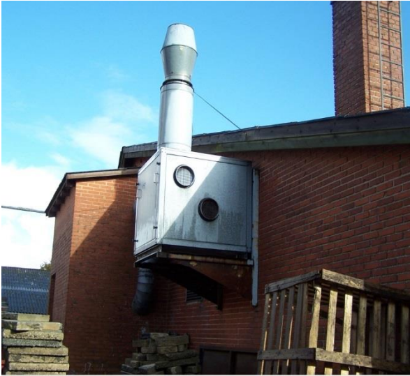
Afkast for svejserøg og slibninger via filter
