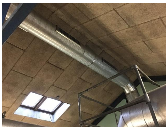
Varmen i hallen udnyttes nu som sekundærluft
