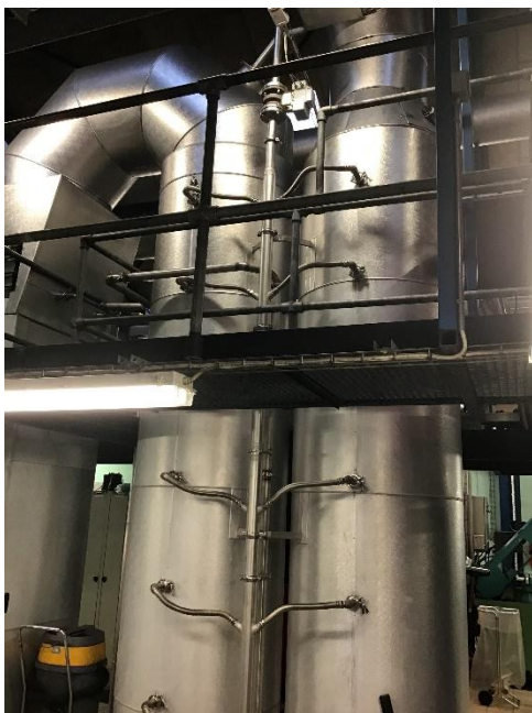
Ny renoveret røgvexler med styring
