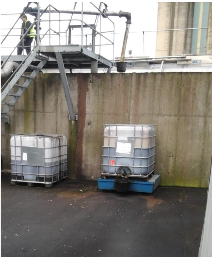
Pallettanke i brug med antioxidant
