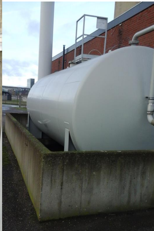
Tank til kedelanlæg
