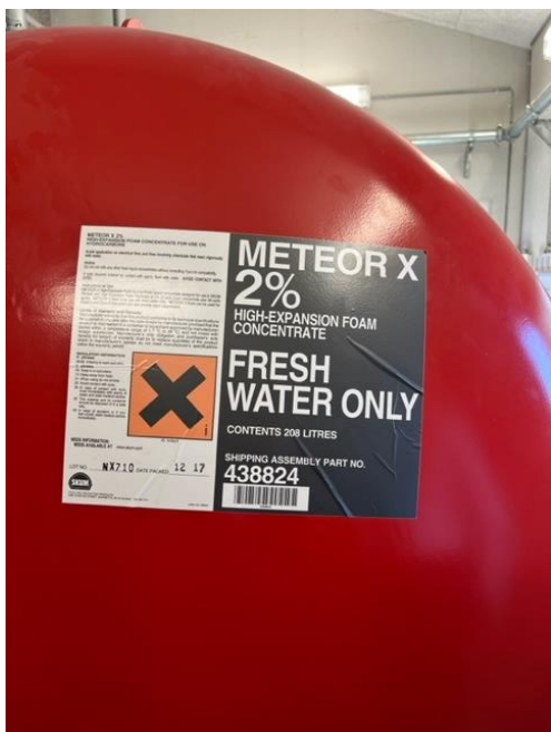
Foto 1: Ståltank med brandslukningsskum Meteor X 2%. Det fremgår af mærkat på tanken, at tanken indeholder 208 liter.
