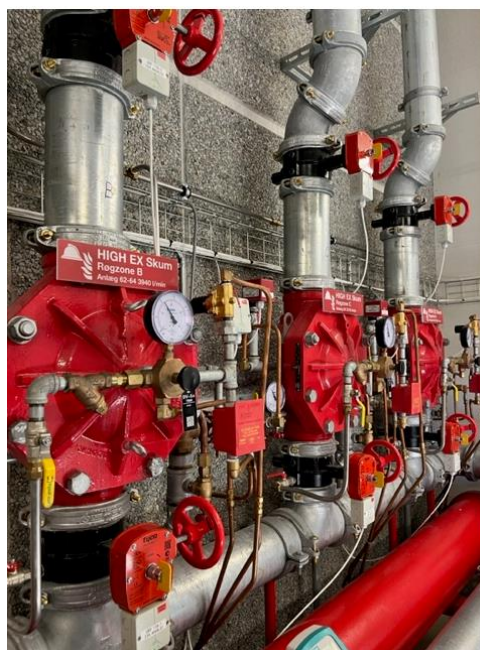
Foto 2: Rørføringer til brandslukningsskum.
