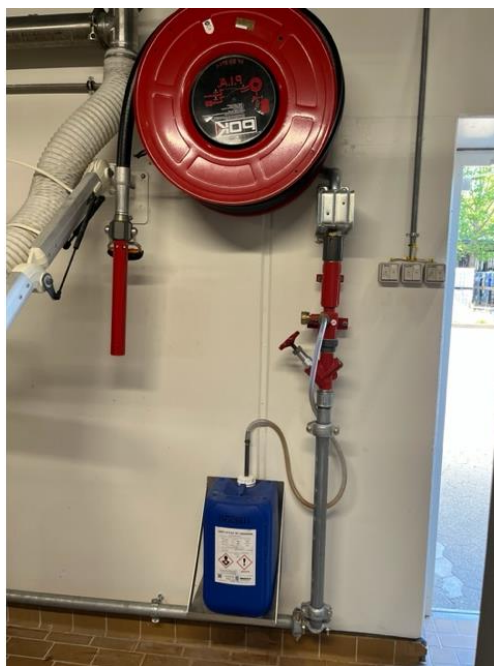
Foto 6: Brandslukningudstyr på væg
