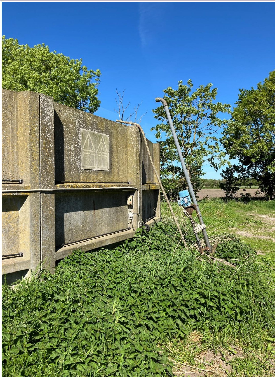
Gyllebeholder, dykket indløb
