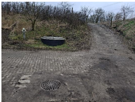
Pumpestation 3 nordlig til lagune 2- Dækslet til S.F. brønd ses foran
