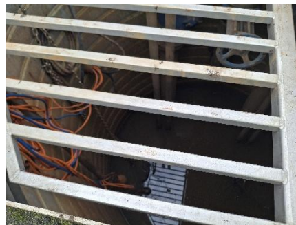
Kig ned i Pumpestation 3, målere ses.
