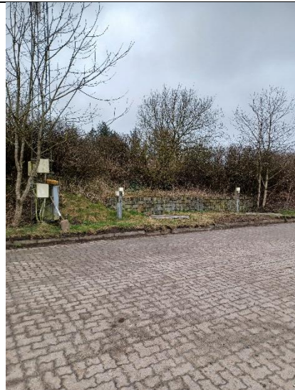
Pumpestation 1 beliggende midt for lagune 1
