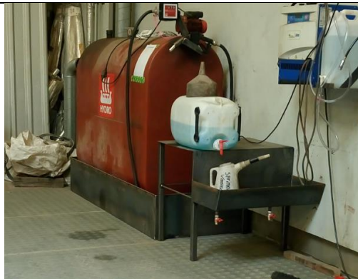
Billede nr. 3: Tæt belægning og opsamling ved opbevaring af flydende produkter (2021)
