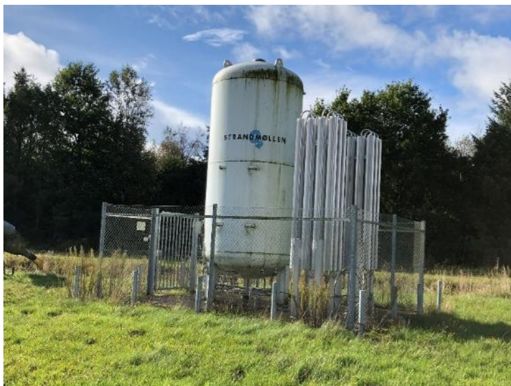
Dambrugets eksisterende ilttanke- flyttes.
