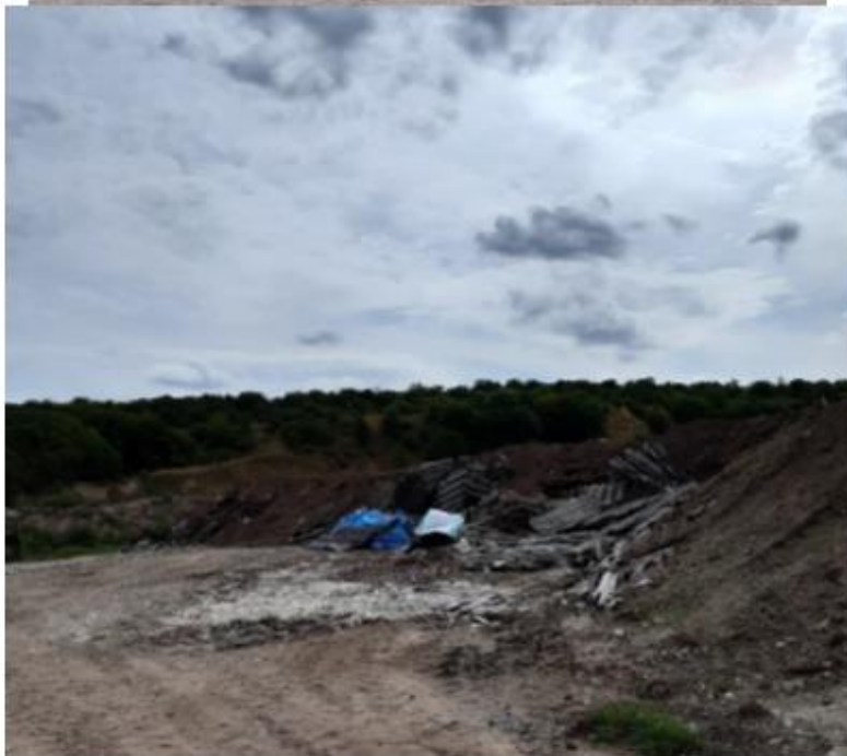
Figur 5 håndtering af asbest på enhed 4.2.1 består i aftipning af asbest og delvis afdækning med jord af de brudte plader.
