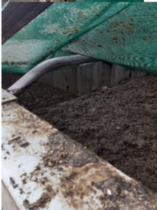
Figur 12 Container til den færdige pulp, hvor det først skal passere et sandfang for at gå videre til den anden del af containeren, hvorfra pulpen kan pumpes over i en tankvogn, som kører det til renseanlægget.
