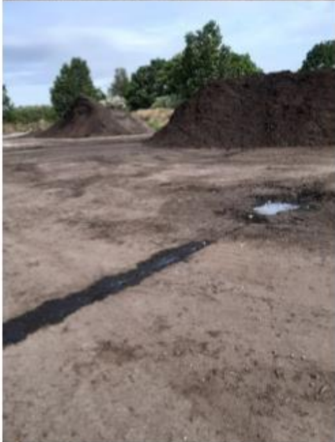
Figur 9 Defekt belægning på pladsen til kompostering.
