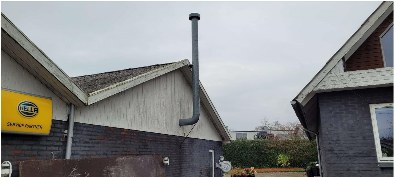
Udsugningsafkast fra punktudsugning for udstødningsgas m.m.
