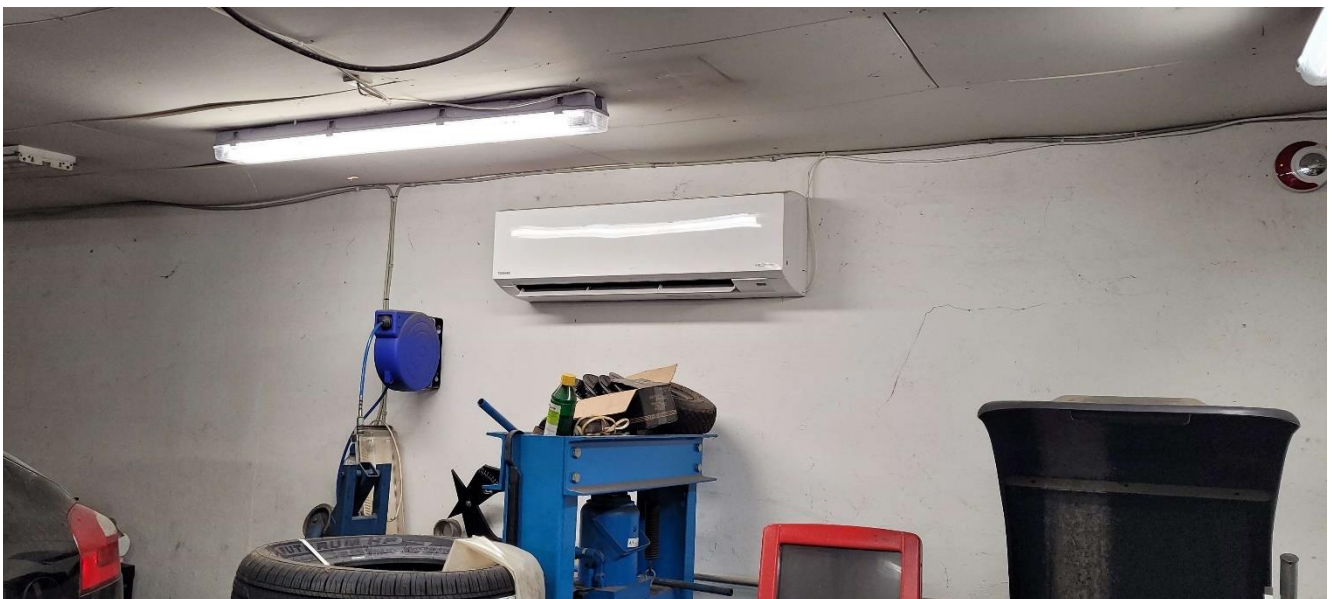
Der er installeret to varmepumper på værkstedet.
