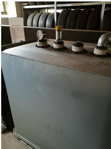
Spildolietanken er også placeret i rummet ved siden af værkstedet
