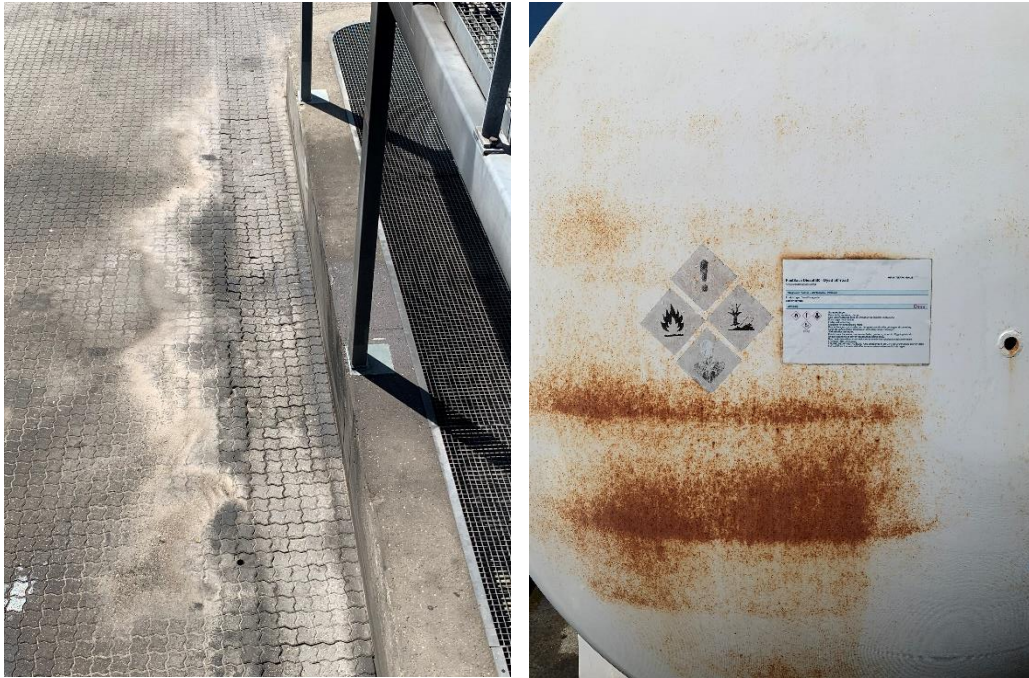
På venstre billede ses den opkørte belægning ved tankpladserne ved tankgård nr. 43. På højre billede ses tankgårdens dieseltank med dens falmende faremærkeskiltning.
