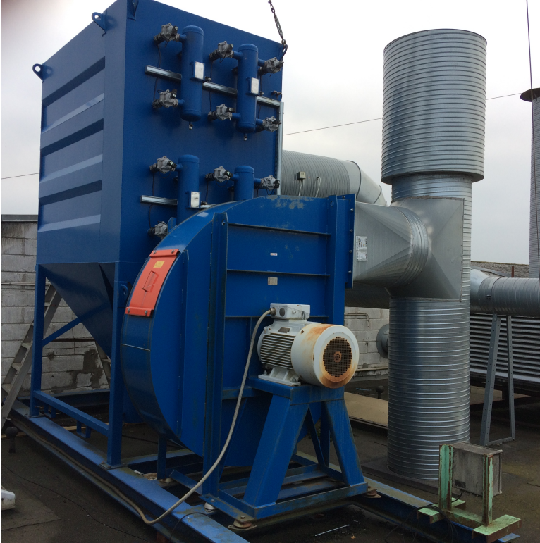
Billede 14 Ventilationsanlæg på tag
