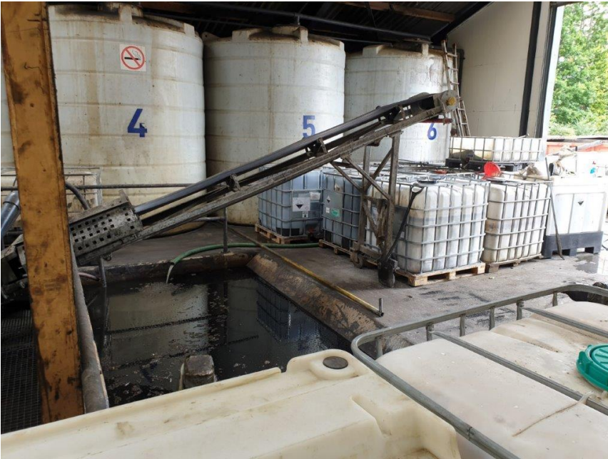
Lagertanke, gulvtank og palletanke med farligt affald
