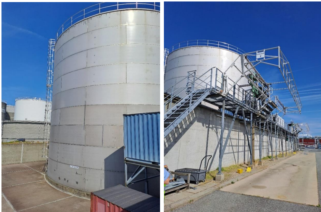
Billede A – Til venstre: YARA tank med salpetersyre; Til højre: Fyldeplads hvor tankbiler bliver påfyldt. Nederst til venstre i billede ses trækvogn med kattegrus. Kloaksump lukkes ved hjælp af afspærringsventil, således evt. spild kan opsamles.
