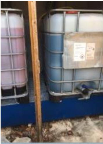
Foto 4: Beholder med væske på spillbakken men ved brudt belægning.
