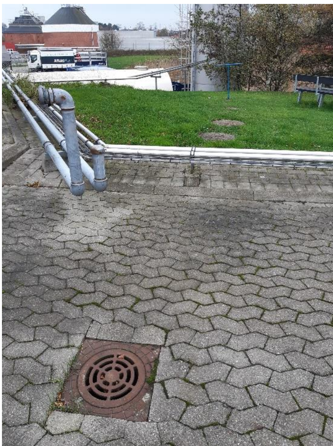
Photo 6 - Påfyldningsplads til ammoniaktank og olietank
