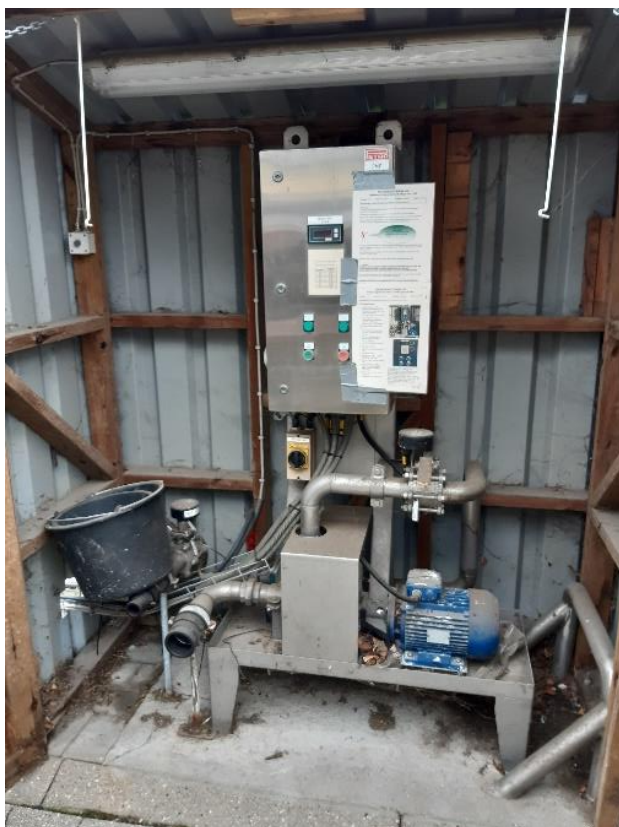
Photo 5 - Ammoniaktank påfyldning, overvågning og instruks for påfyldning
