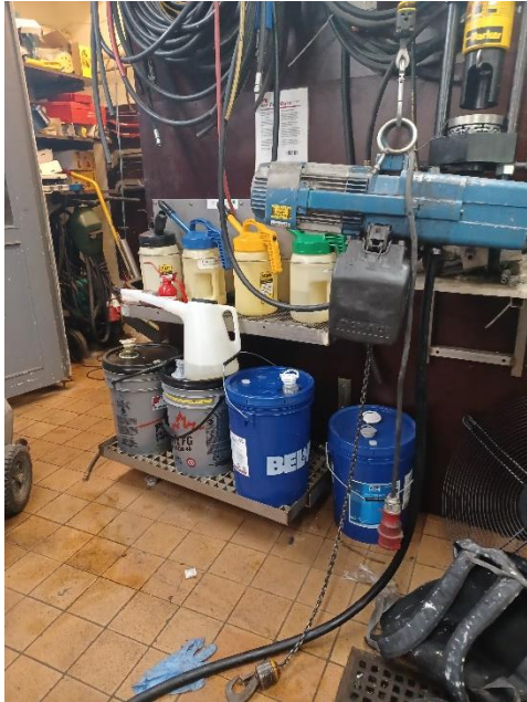
Bel-Ray tønde placeret ved siden af opsamlingsbakken på virksomhedens værksted.
