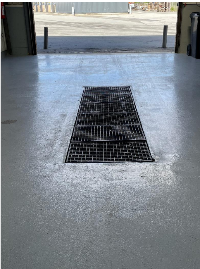
Afløb i vaskehal
