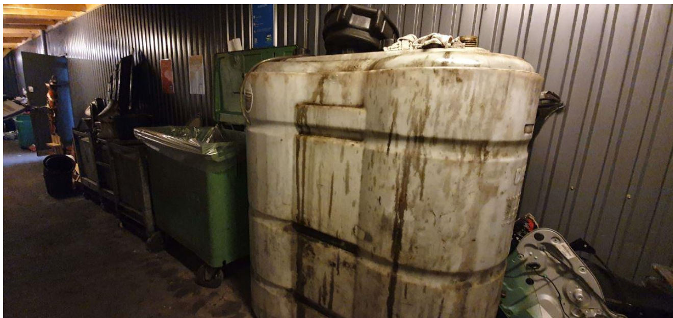
Billede 2. Farligt affald. Spildolie i den dobbeltvæggede beholder til højre, og flydende farligt affald i beholderne til venstre.
