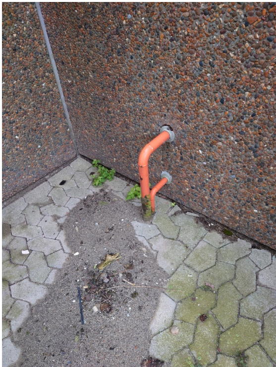
Rørsystemet fra centralen går ud og ned i jorden.
