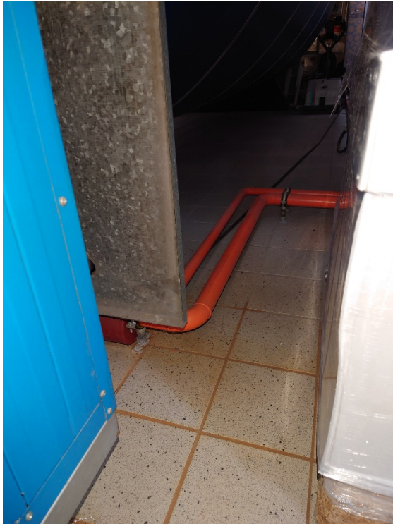
Rørsystem til kedelanlægget.
