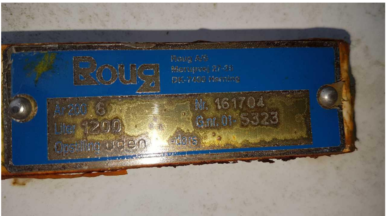
Udendørs fyringsolietank fra 2006 på 1200 liter.
