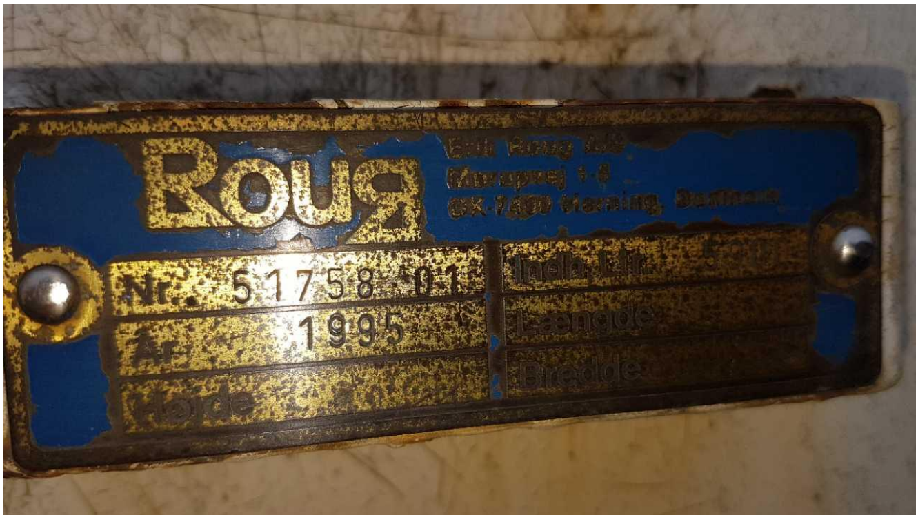
Udendørs dieselolietank fra 1995 på 5900 liter med stander.
