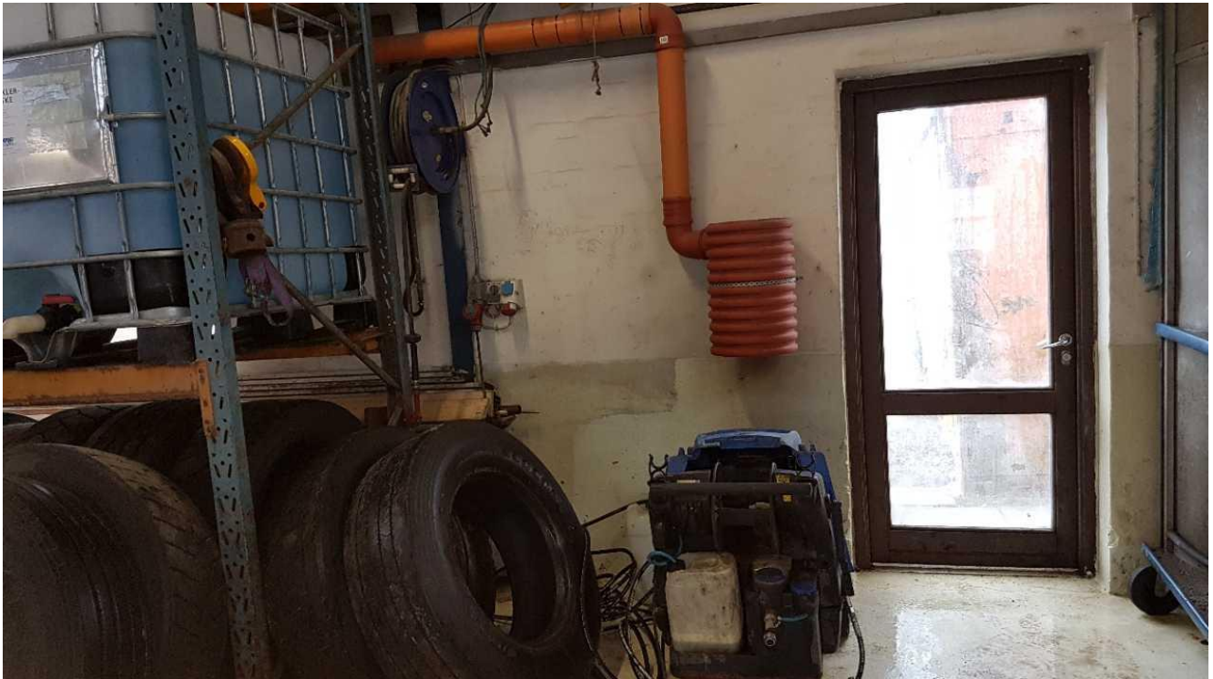
Punktudsugning over dampenser.
