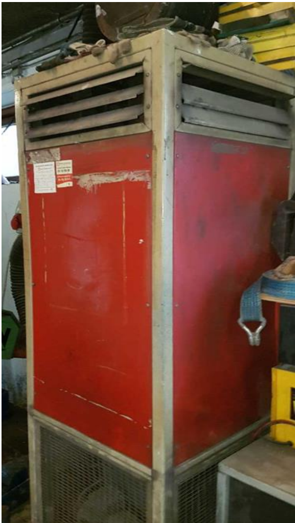
Oliefyret kalorifere på værkstedet/vaskehallen.
