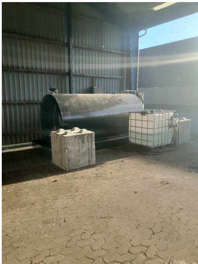
Foto 1. Opstilling af diesel og ad Blue tank i bygning (biaktiviteter).
