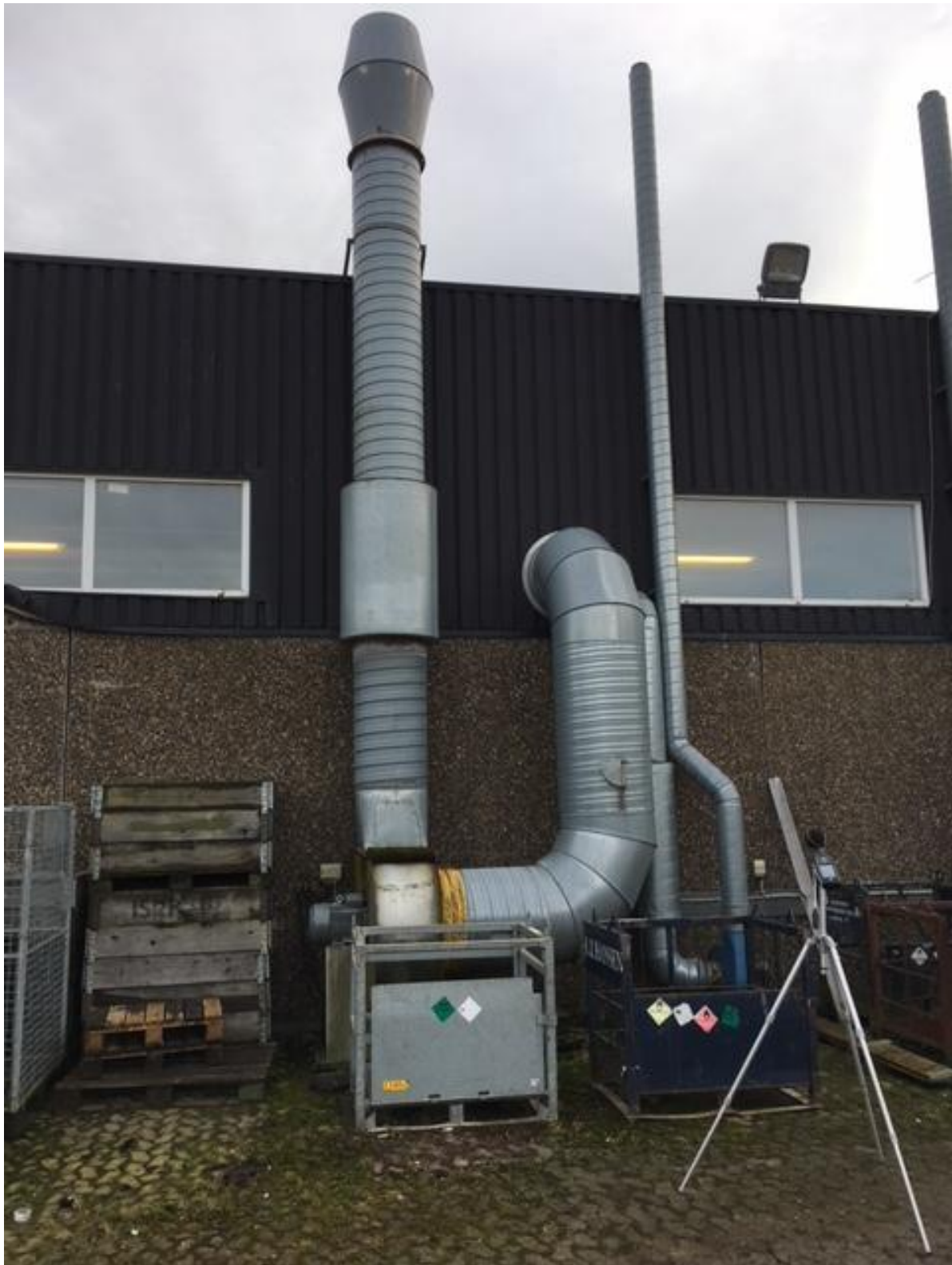
Figur 4: Udsugning fra olie- og kemikalierum (længst til venstre) og punktudsugning fra svejsesteder (længst til højre)
