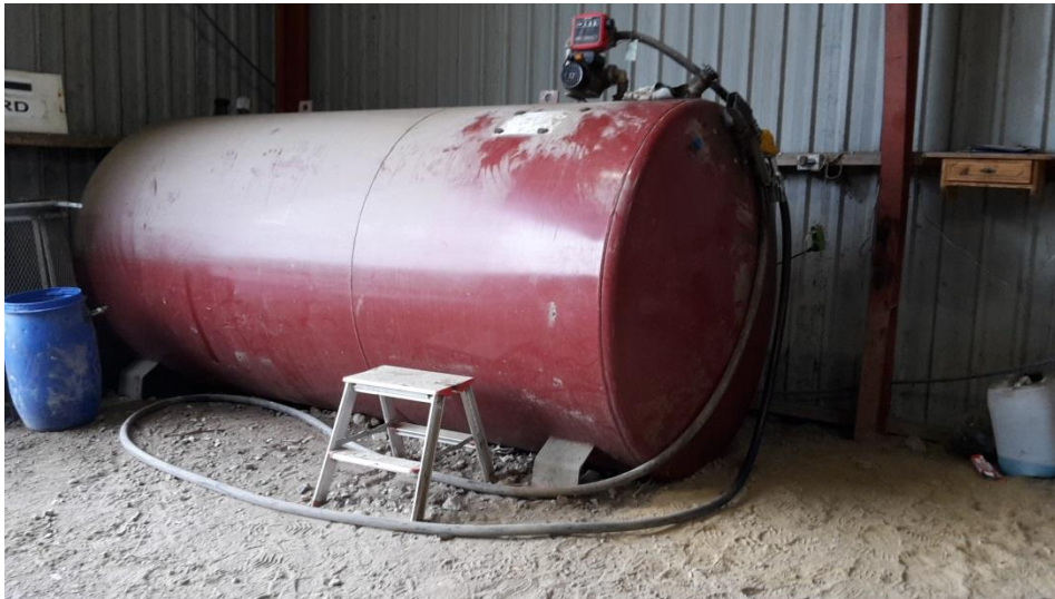
Foto 2. Opbevaring af dieselolie i godkendt tankanlæg (deponeringsanlæg).
