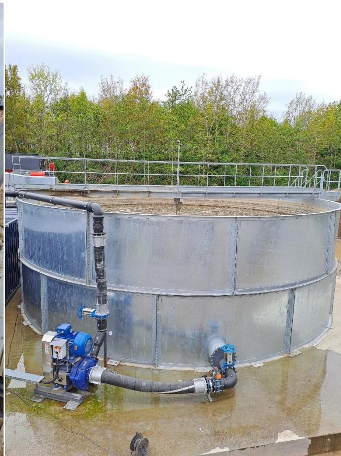
Port 6: Vandbeholderen til jordvaskeanlægget
