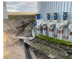
Slam tilkobling på Skagen renseanlæg
