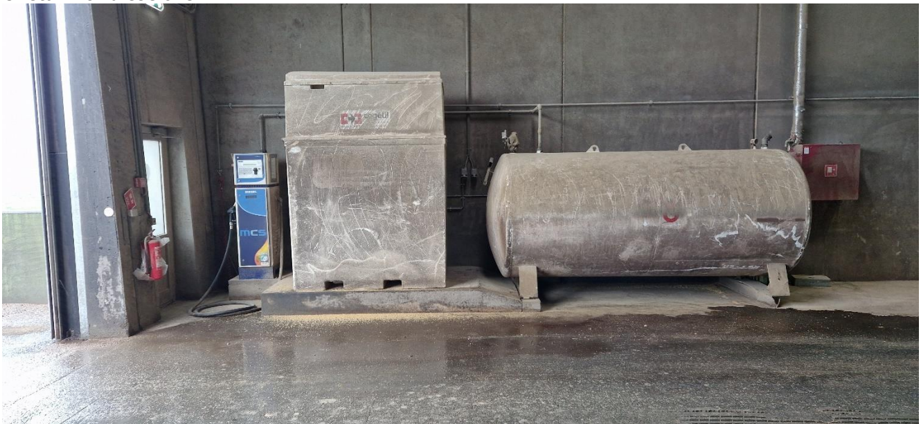
Dieselolietank og dobbeltvægget tank til AdBlue.
