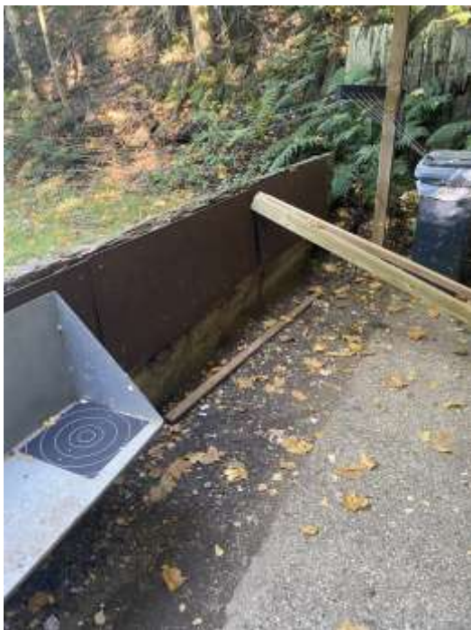
Væggen skal renoveres (foto fra 2022)
