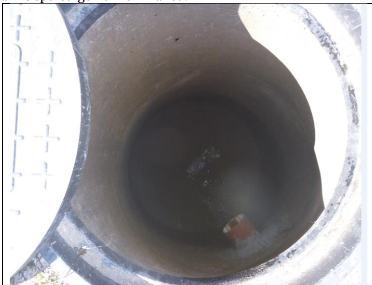
Fig. 2 Prøvebrønd til udtagning af perkolatprøver er fundet. Der løb perkolat til ved tilsynet.
